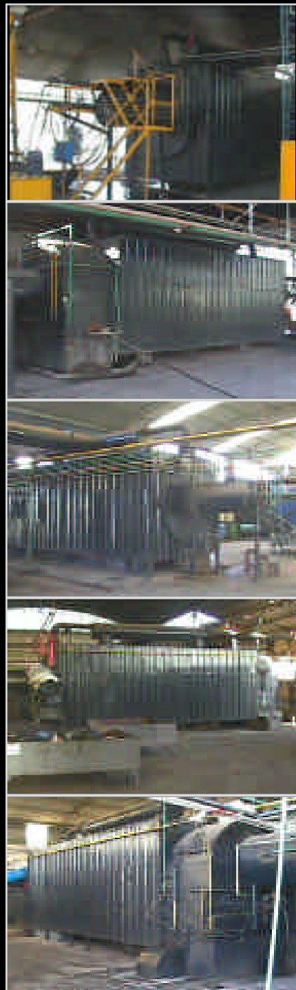
AREA HORNOS INCINERADOR
